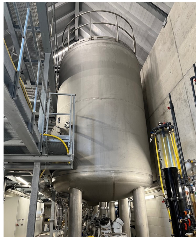
Abb. 1: Aktivkohlefilter im Wasserwerk Rauental. Fotos: Hannah Adam
